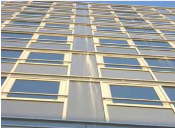
Abb. 15: Beispiel einer Verätzung an der Fassade eines Bürogebäudes, Quelle: Sachverständigenbüro Dipl. (FH) Eberhard Achenbach, Wardenburg
