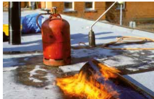
Abb. 1: Typische Zündquellen auf der Baustelle, Quelle: VdS 2216
